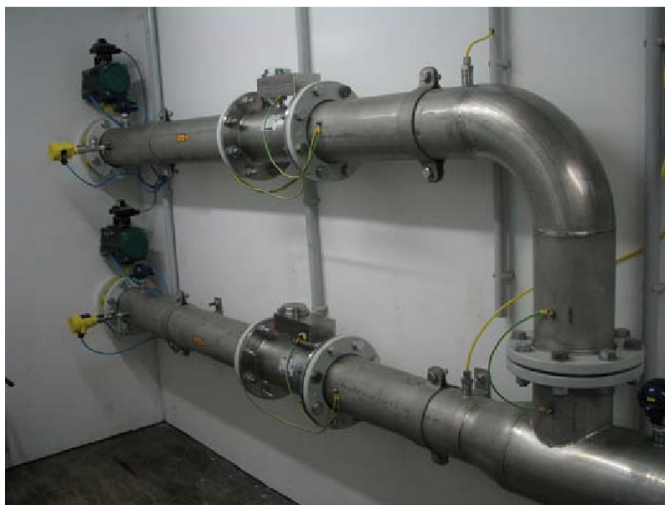
Gaszulieferung von zwei Biogasanlagen zu einer Einspeiseanlage mit Integration der Gasanalyse und Abrechnung des Gases auf Basis der Feuerungswärmeleistungsberechnung.
