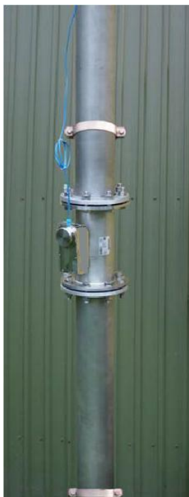
Einbau des KGD 300 in einer senkrecht fallenden Leitung am Fermenter
